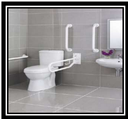
Instalaciones de lavabos y baños
